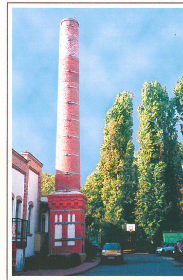
Charakterystyczny komin kotłowni dawnej drugiej gazowni w Sopocie zachowany do dnia dzisiejszego bez zmian. W końcu XX wieku przeszedł on remont, który pozwolił na dalsze jego trwanie. (fot. Tadeusz Gruszczyński)
